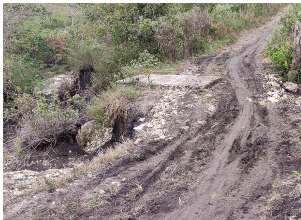
Salah satu titik yang akan dilakukan perbaikan
